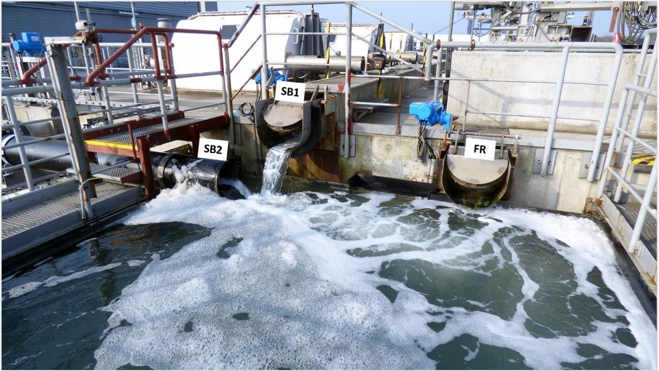
Abbildung 11: Zuleitungsrinnen einmündend in den Fischsammelcontainer (ab August 2017) FR: Feinrechenrinne, SB 1 und 2: Siebbandrinne 1 und 2; Quelle: MARINE SCIENCE SERVICE (2019b)
